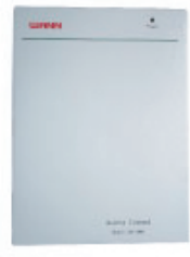
ชุดจ่ายและสำรองไฟฟ้า
